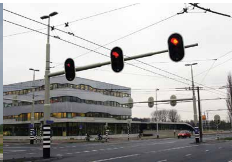
uithoudercombinatie met bovenleiding en openbare verlichting
